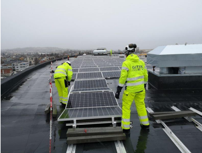
Figur 3: Solceller på flatt tak i Ranheimsvegen 9.
