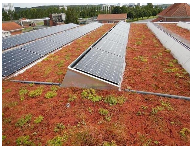
Figur 4: Solceller kombinert med sedumtak.
