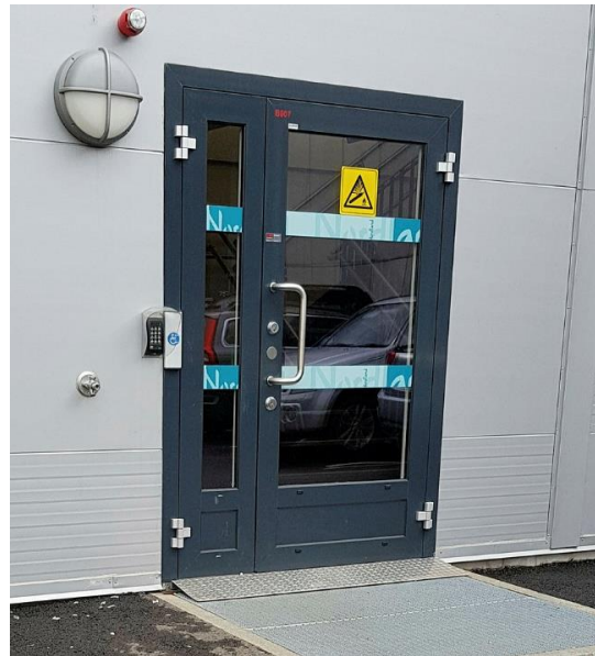
Dør inn til Polarsirkelen videregående skole med både elektrisk døråpner, mulighet for rullestol og merking av glass for svaksynte
